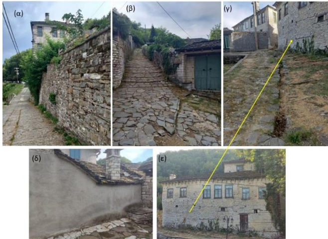
Εικόνα 30. (α) Βιολογική φθορά στο τοίχιο αντιστήριξης παρόλο που υπάρχουν προστατευτικές πλάκες από πάνω, (β) Αποκόλληση πλακών στο καλντερίμι, βιοφθορά στις πλάκες του οθορού και ανερχόμενη υγρασία στους μαντρότοιχους, (γ, ε) Μεγάλο κτίριο στην πλατεία του χωριού που έχει υποστεί καθίζηση λόγω του χαλαρού εδάφους θεμελίωσης. Επίσης, παρατηρούνται αποκολλήσεις λίθων και ανερχόμενη υγρασία, (δ) Ανοδική και καθοδική υγρασία σε επιχρισμα από ταμμένο.
