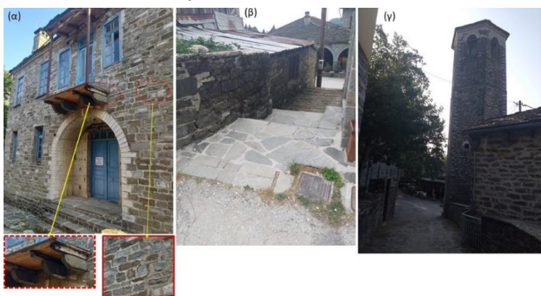
Εικόνα 27. (α) Ξενοδοχεία με νεότερο αρμολόγημα από τσιμεντοκονίαμα, (β) Ανακατασκευή καλντεριμιού με πλάκες σχιστόλιθου, έντονη υγρασία και βιοφθορά στην τοιχοποιία, οξείδωση λαμαρινών, (γ) Μαύρες κρούστες από την υγρασία στο καμπαναριό.
