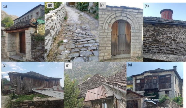
Εικόνα 28. (α) Βιοφθορά στη στέγη του οβορού καθώς και στο παλιό τμήμα του μαντρότοιχου που είναι απροστάτευτο από πάνω, (β) Παλιό καλντερίμι, (γ) Υγρασία στη ξύλινη θύρα εισόδου, (δ) Φθορά στους λίθους της τοιχοποιίας και της στέγης, (ε) Βοηθητικός παραδοσιακός χώρος για ζώα με ξερολιθιά και ξύλο. Εντοπίζονται φθορές στα πρόχειρα στοιχεία όπως, ξύλα και λαμαρίνες, (ζ) Φθορές στις πλάκες της στέγης, αποκόλληση τσιμεντοκονιαμάτων και φθορά στον ξύλινο διάκοσμο, (η) Έντονη παθολογία στο ξύλινο σαχνισί.
