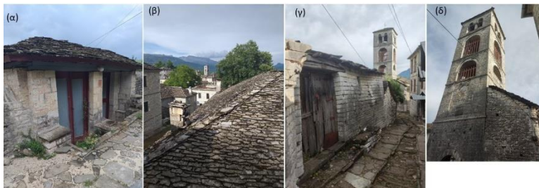
Εικόνα 31. Ανερχόμενη υγρασία στην κατοικία, βιολογικές κρούστες στις πλάκες της στέγης, (β) Βιολογικές κρούστες και εκφυλλώματα στις πλάκες της στέγης (γ) Έντονη ανερχόμενη υγρασία και μαύρες κρούστες στην τοιχοποιία καθώς και απόκλιση από την κατακόρυφο. Φθορά στην ξύλινη εξώθυρα λόγω υγρασίας, (δ) Ανερχόμενη υγρασία και μαύρες κρούστες στο καμπαναριό.
