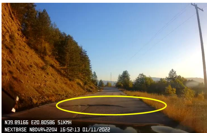
Εικόνα 40. Αστοχία οδοστρώματος (Περίπτωση ανισόπεδης κατανομής ασφαλτόστρωσης).
