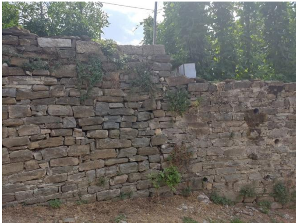
Εικόνα 26. Επέμβαση σε τμήμα τοιχίου με τσιμέντου. Παρατηρείται ότι το τμήμα που δεν έχει υποστεί επέμβαση είναι σε καλύτερη κατάσταση. Αυτό συμβαίνει ενδεχομένως γιατί γίνεται καλύτερη απορροή των υδάτων και δεν συγκρατούνται στην έσω παρειά του τοίχου.
