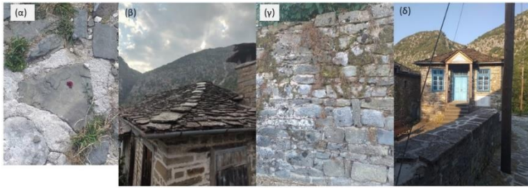
Εικόνα 29. (α) Εκφύλλωμα σε σχιστολιθική πλάκα σε νεότερο καλντερίμι, (β) Βιοφθορά και εκφύλλωμα στις πλάκες της στέγης, (γ) Βιοφθορά στους λίθους της τοιχοποιίας, (δ) Τσουλφείο Φαρμακείο: έντονη υγρασία στο εσωτερικό.
