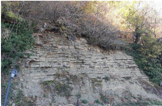
Εικόνα 7. Τομή στον δρόμο λίγο πριν την είσοδο του οικισμού Δίλοφο, που υποδεικνύει την ύπαρξη αποσαθρωμένων γεωλογικών σχηματισμών με έντονα σημάδια γεωτεχνικής αστάθειας Πηγή: Η. Δημητρίου, 2022.
