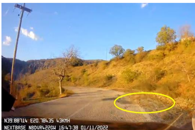
Εικόνα 39. Αστοχία οδοστρώματος λόγω ασυνέχειας και έλλειψη οριζόντιας σήμανσης.
