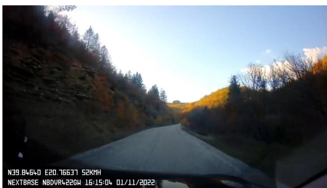
Εικόνα 45. Απουσία οριζόντιας σήμανσης και πλέγματος συγκράτησης στο πριανές.
