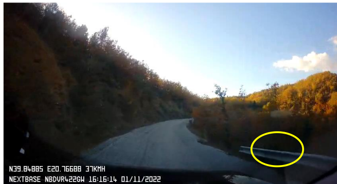
Εικόνα 52. Κακή απόληξη στηθαίου και αστοχία οδοστρώματος.
