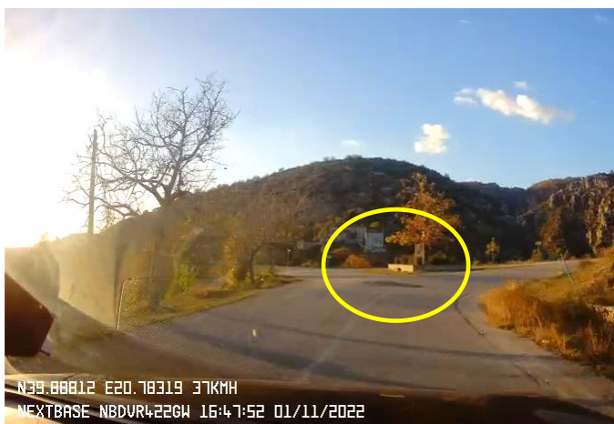
Εικόνα 44. Απουσία οριζόντιας διακεκομμένης σήμανσης στην είσοδο και έξοδο της διασταύρωσης.
