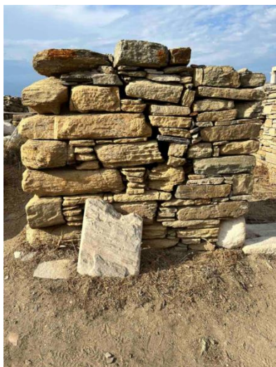
Εικόνα 70. Απώλεια συνδετικού υλικού στην τοιχοποιία
