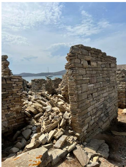
Εικόνα 67. Πρόσφατη κατάρρευση τοιχοποιίας. Απουσία συνδετικού υλικού
