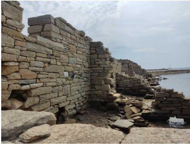
Εικόνα 40. Παράκτια σε επαφή με τη θάλασσα. Έχει γίνει υποσκαφή θεμελίων και υπάρχουν εκτεταμένες καταρρεύσεις. Επίσης έχει φύγει πλήρως το συνδετικό κονίαμα και το επίχρισμα
