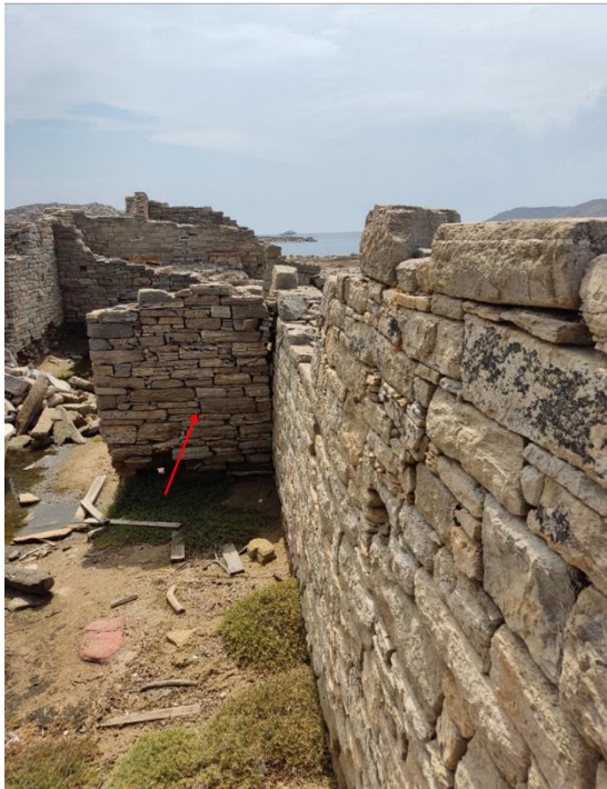
Εικόνα 65. Τοιχοποιία σε κίνδυνο κατάρρευσης λόγω αστοχίας εδάφους θεμελίωσης
