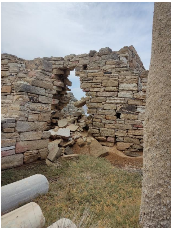
Εικόνα 66. Πρόσφατη κατάρρευση τοιχοποιίας λόγω αστοχίας της θεμελίωσης
