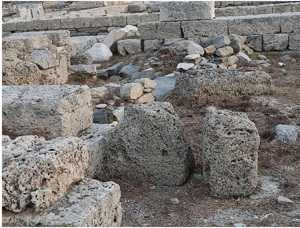
Εικόνα 37. Κυψέλλωση, απώλεια υλικού και βιολογικές επικαθήσεις
