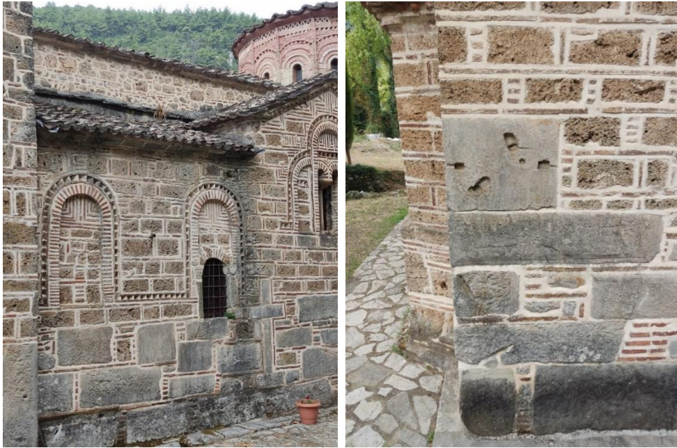
Εικόνα 38. (α) Υγρασία και μαύρες κρούστες στους ασβεστόλιθους στη βάση του κτιρίου, (β) Διαβρωμένοι ασβεστόλιθοι με παράλληλες μικρο-ρωγμές, ασβεστόλιθοι με απολέπιση και πωρόλιθοι με κυψέλλωση και θελονισμό, καθώς και εμφανείς εξανθήσεις αλάτων στους οπτόπλινθους. Πηγή: ΕΛΛΗΝΙΚΗ ΕΤΑΙΡΕΙΑ Περιβάλλοντος και Πολιτισμού, 2024.
