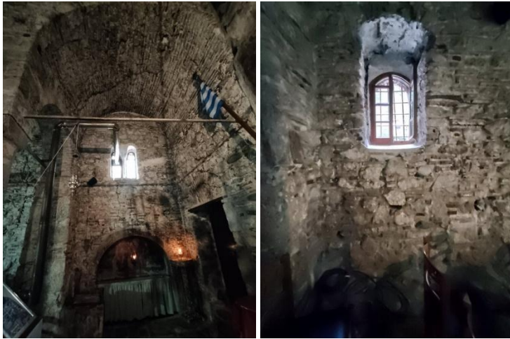
Εικόνα 47. Κατακόρυφες ρωγμές στην τοιχοποιΐα του Ναού, λόγω αστοχίας εδάφους θεμελίωσης. Πηγή: ΕΛΛΗΝΙΚΗ ΕΤΑΙΡΕΙΑ Περιβάλλοντος και Πολιτισμού, 2024.
