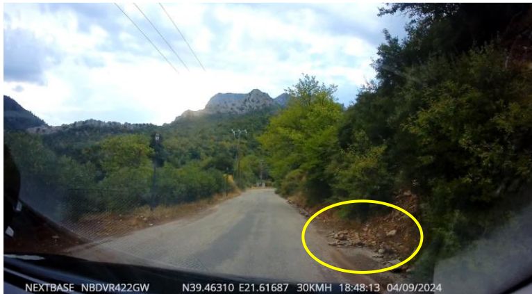
Εικόνα 59: Κατάπτωση υλικών από το πρανές στο οδόστρωμα
