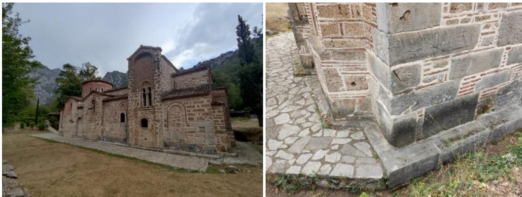
Εικόνα 94. Υγρασίες στο εξωτερικό του Ναού λόγω λιμναζόντων υδάτων. Δημιουργία κατάλληλου επιχρίσματος στη βάση (σοβατεπί) με κοίλη επιφάνεια για την απορροή υδάτων.
