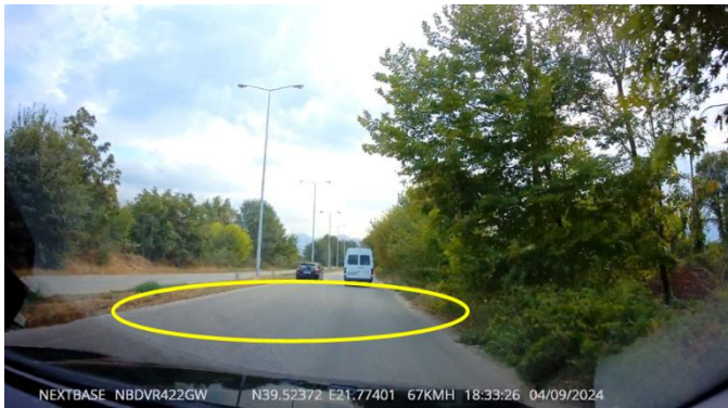
Εικόνα 65: Έλλειψη ή χωρίς συντήρηση διαγράμμιση λωρίδας κυκλοφορίας και ερεισμάτων
