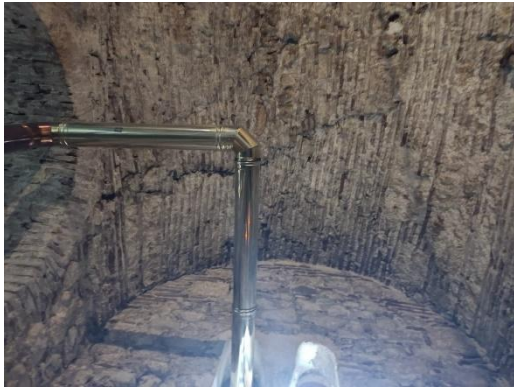
Εικόνα 84. Διαμήκης ρωγμή στο θόλο
