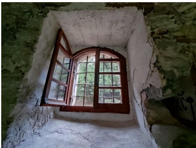
Εικόνα 42. Ελλιπής συντήρηση επιχρισμάτων. Παρατηρούνται αποκολλήσεις, εκφυλλώματα και υγρασία. Πηγή: ΕΛΛΗΝΙΚΗ ΕΤΑΙΡΕΙΑ Περιβάλλοντος και Πολιτισμού, 2024.
