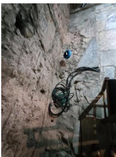
Εικόνα 97. Το δάπεδο στο εσωτερικό του Ναού όπου έχουν αφαιρεθεί πλάκες και προτείνεται να δημιουργηθεί περιμετρικά στο εσωτερικό του Ναού κανάλι αποστράγγισης.
