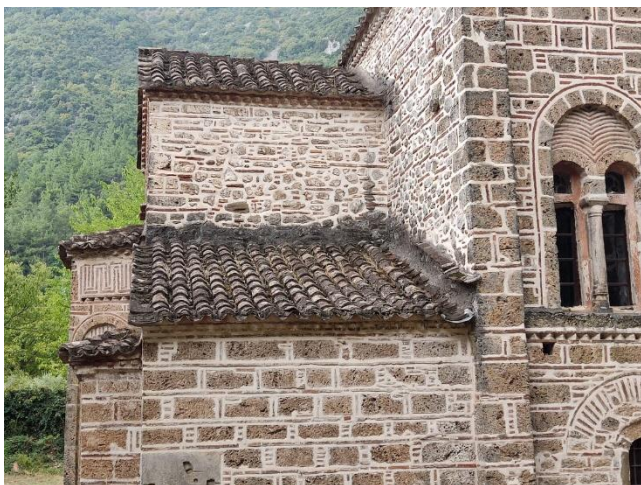
Εικόνα 98. Κατερχόμενη υγρασία και ανάγκη αντικατάστασης κεραμιδιών και δημιουργία υδρορροών με πατητό κονίαμα για καλύτερη απορροή υδάτων
