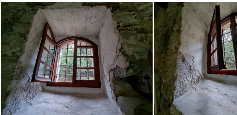
Εικόνα 91. Κονιάματα στο εσωτερικό του Ναού που χρήζουν συντήρησης
