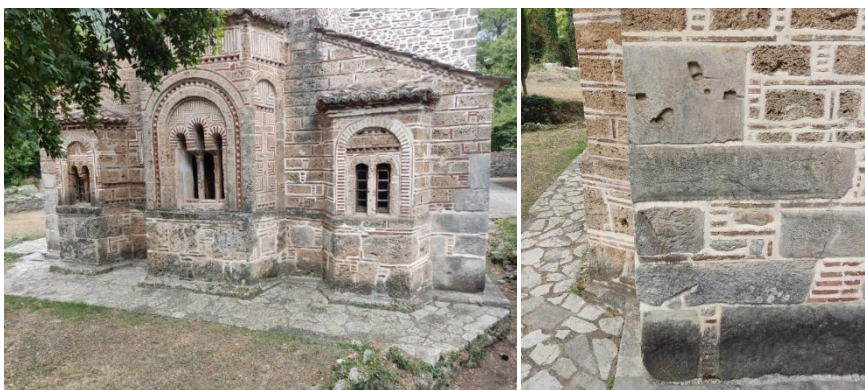
Εικόνα 95. Υγρασία από τριχοειδή αναρρίχηση ύδατος
