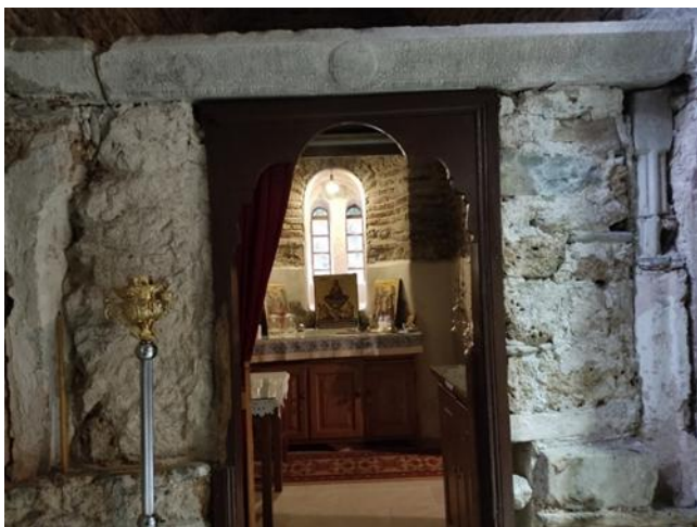
Εικόνα 40. Θραύση μαρμάρινης δοκού λόγω αστοχίας υποκείμενης τοιχοποιίας. Επιπλέον, παρατηρείται επιφανειακή φθορά με τα χαρακτηριστικά του διάκοσμου στο κέντρο να έχουν ελαφρώς αλλοιωθεί. Πηγή: ΕΛΛΗΝΙΚΗ ΕΤΑΙΡΕΙΑ Περιβάλλοντος και Πολιτισμού, 2024.
