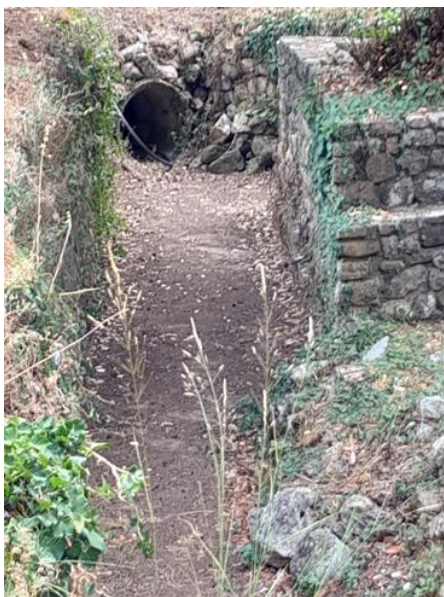
Εικόνα 51. Η έξοδος των ομβρίων και των drainage από τον περίβολο του ναού, που έχει κατασκευάσει ο Α. Ορλάνδος
