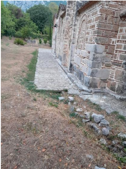
Εικόνα 53. Η σημερινή μορφή της απόληξης του καναλιού Ομβρίων, μετά την τελευταία εργολαβία, που τελικώς «συγκρατεί» και τα Ομβρια
