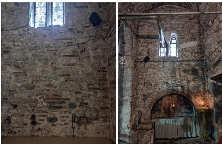
Εικόνα 90. Τοιχοποιίες στο εσωτερικό του Ναού που χρήζουν αποκατάστασης
