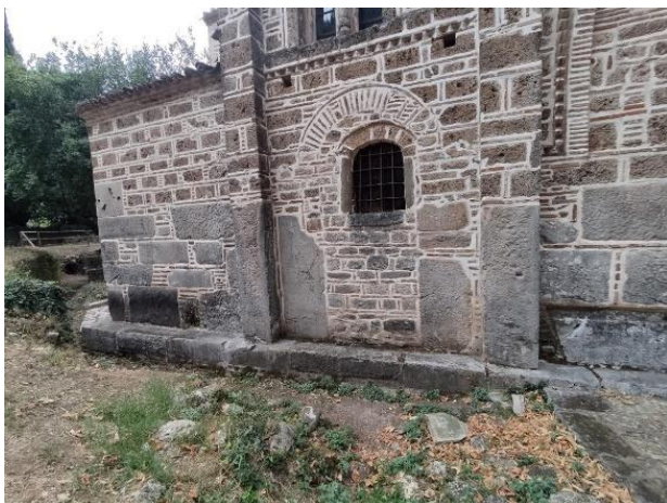
Εικόνα 96. Υγρασία από τριχοειδή αναρρίχηση ύδατος
