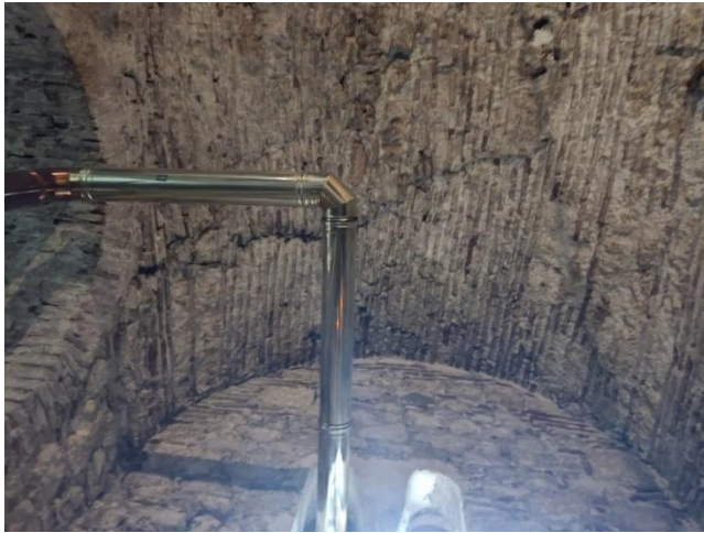
Εικόνα 50. Βιοφθορά, ρωγμή στο θόλο λόγω αστοχίας εδάφους και κακής στεγάνωσης. Πηγή: ΕΛΛΗΝΙΚΗ ΕΤΑΙΡΕΙΑ Περιβάλλοντος και Πολιτισμού, 2024.
