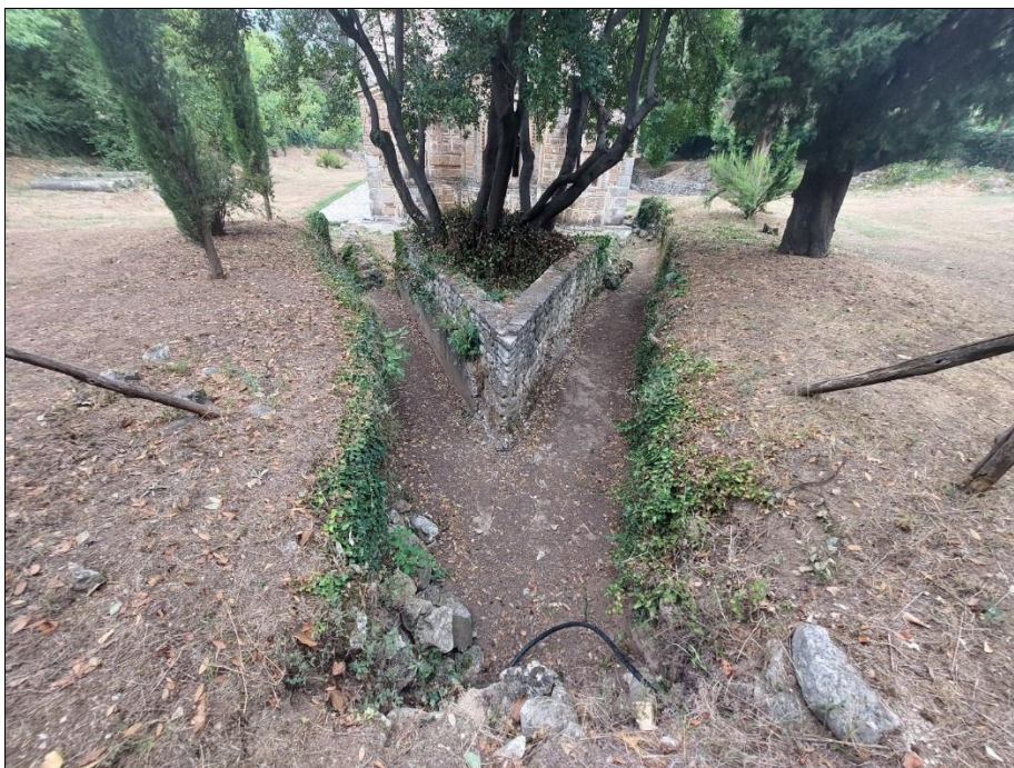
Εικ.162 Πόρτα-Παναγιά. Περιβάλλον χώρος. Αποστραγγιστική τάφρος στα Α του ναού (Σ. Μαμαλούκος Αύγουστος 2024)
