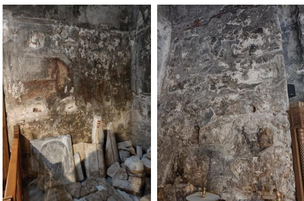
Εικόνα 88. Τοιχογραφία και τοιχοποιία στο εσωτερικό του Ναού που χρήζουν συντήρησης
